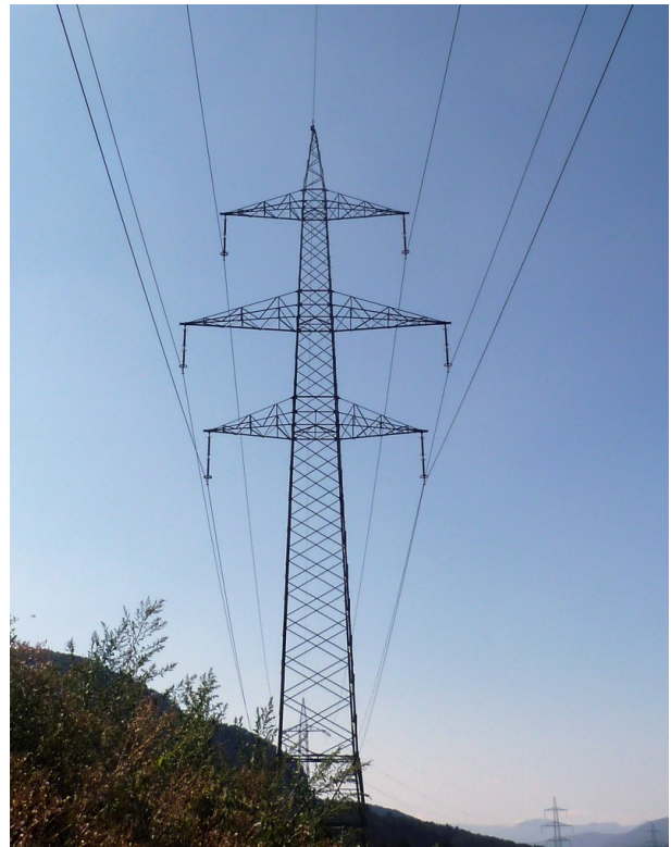
Abb. 1: Die intakte Übertragung der Elektrizität in einem komplexen und verzweigten Netz entscheidet über Wohl oder Wehe der industrialisierten Gesellschaft.
